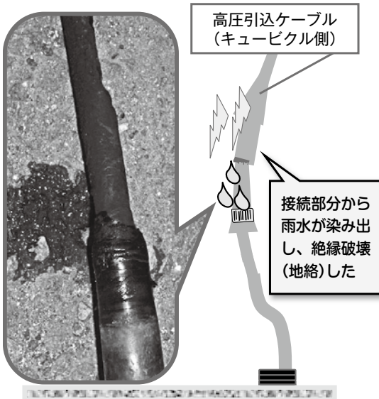
図解2 高圧引込ケーブルのキュービクル側における絶縁破壊（地絡）の状況
