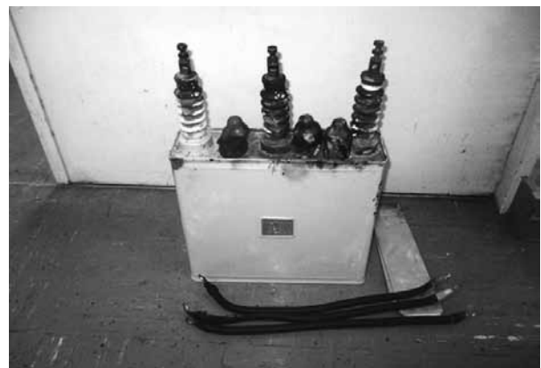
盤内に設置されていたコンデンサ
