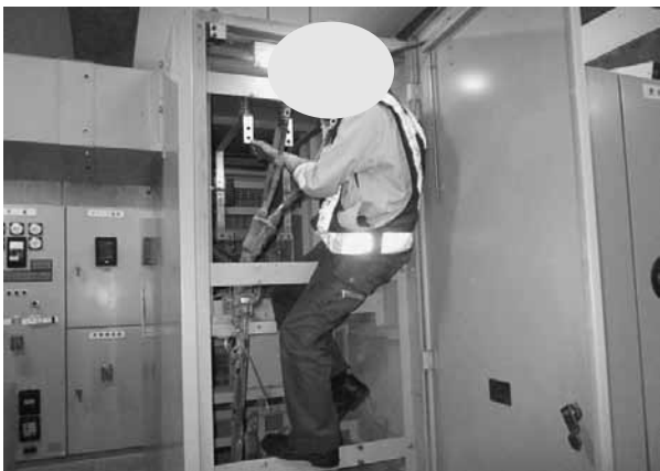
B電気室 配電盤の被災時作業状況(想定)
