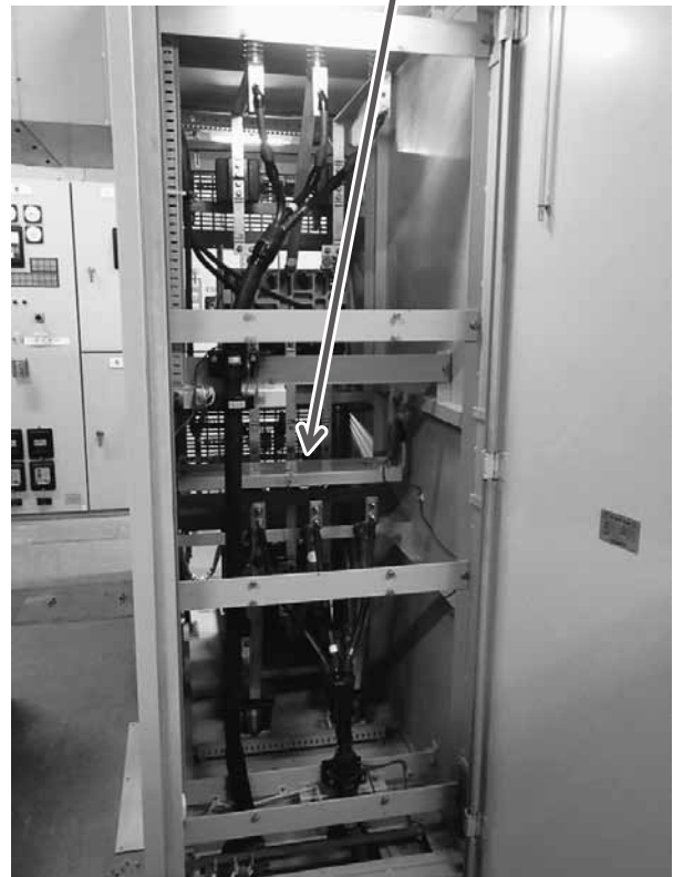
B電気室 配電盤内部
