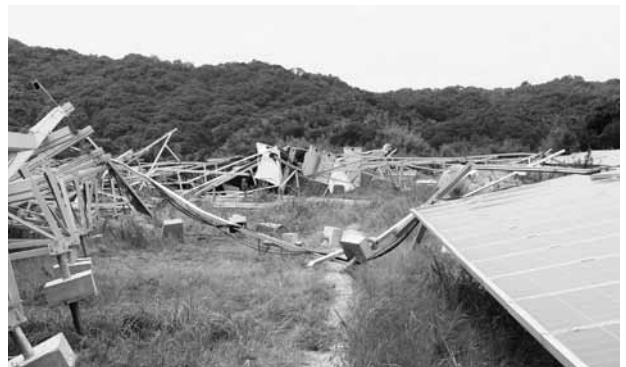
破壊された架台・基礎
