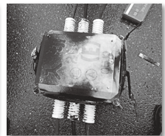
写真2. 雷により内部が焼損したPAS(下側を写す)
