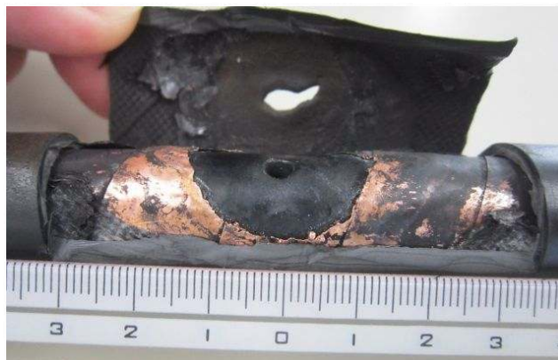
絶縁破壊した高圧ケーブル(赤相)
