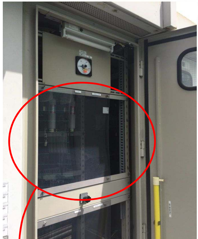
高圧動力盤(盤面)
