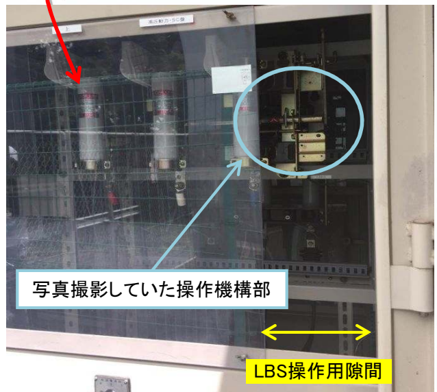
高圧動力盤(盤内)
