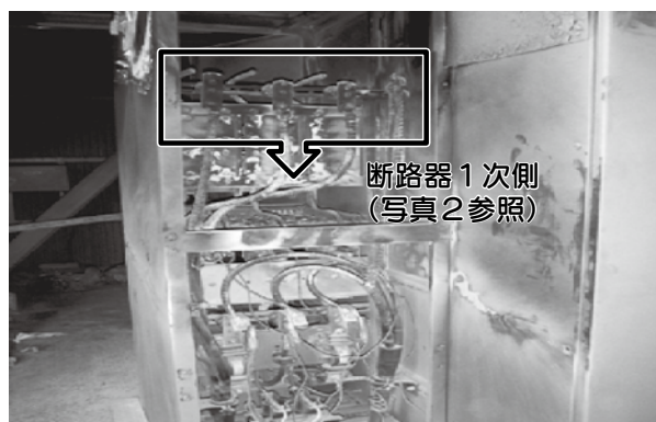
写真1. 3.3kVコンデンサ高圧盤 (事故後)
