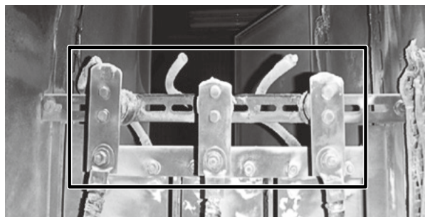
写真2. 断路器1次側端子 (事故時充電中)
