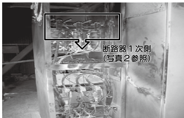
写真1. 3.3kVコンデンサ高圧盤 (事故後)
