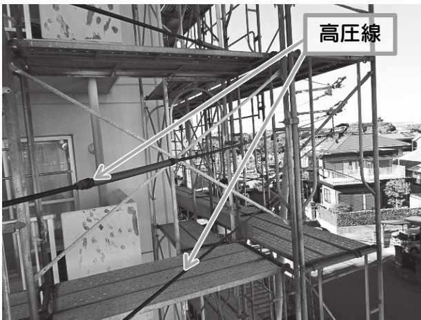
足場を電線が貫通している状況
