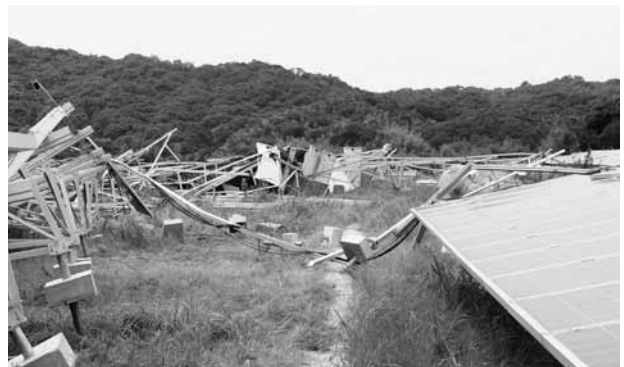
破壊された架台・基礎
