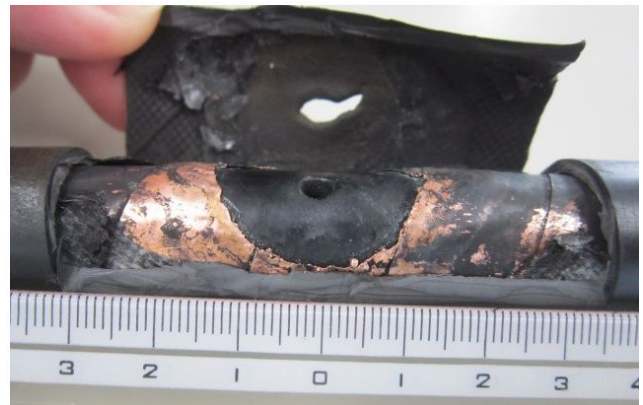
絶縁破壊した高圧ケーブル(赤相)
