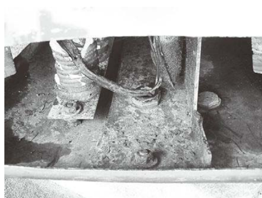
区分開閉器内部 発錆状況
