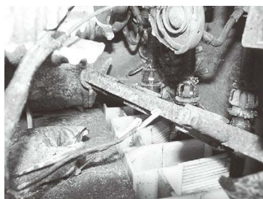
区分開閉器内部 破損状況
