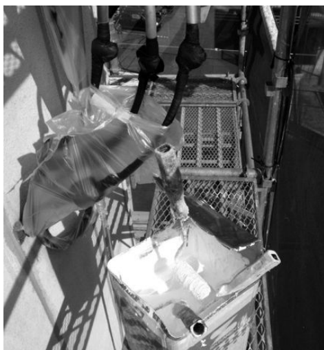
事故発生場所(高圧気中開閉器2次側)
