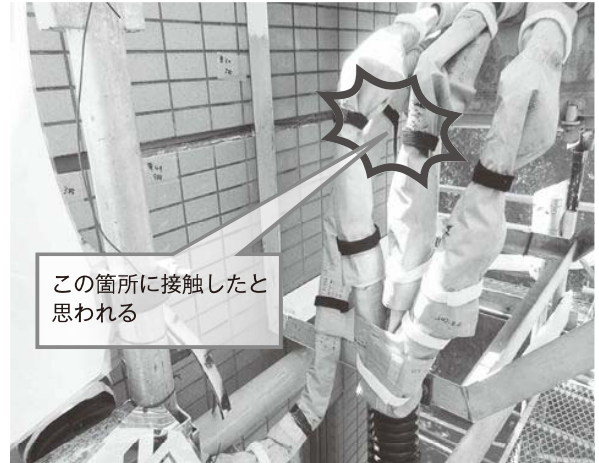
事故発生箇所
