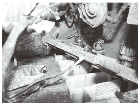
区分開閉器内部 破損状況
