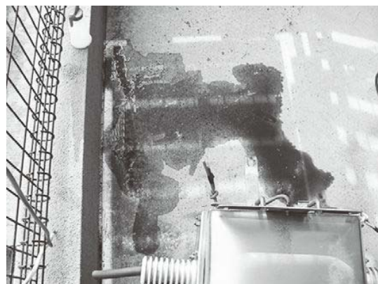
区分開閉器内部 水の漏出状況
