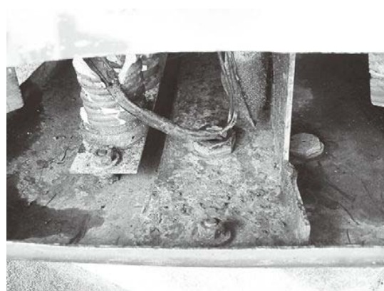
区分開閉器内部 発錆状況
