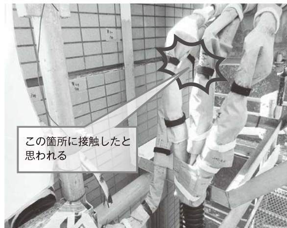
事故発生箇所
