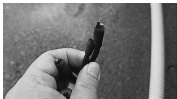
先が溶けてなくなった一次側電線端子
