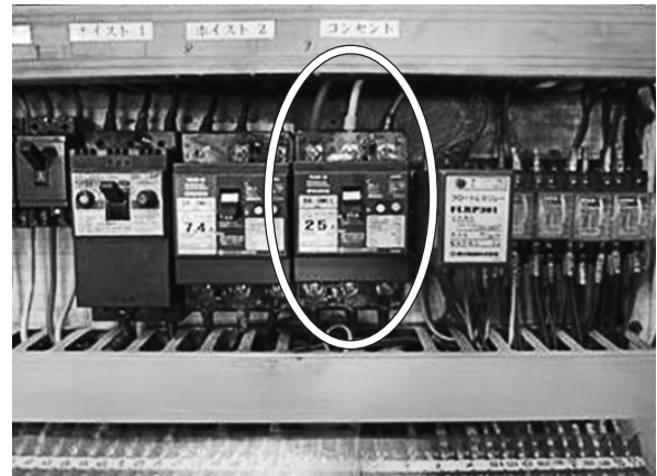
分電盤内改修済みブレーカー
