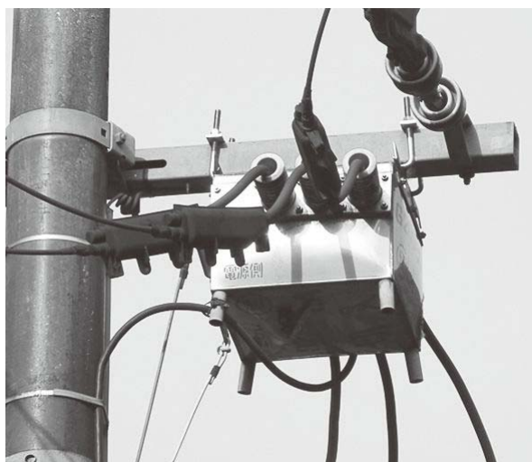
区分開閉器(本体膨らみあり)
