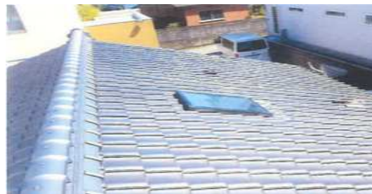
屋根上に飛散したモジュール
