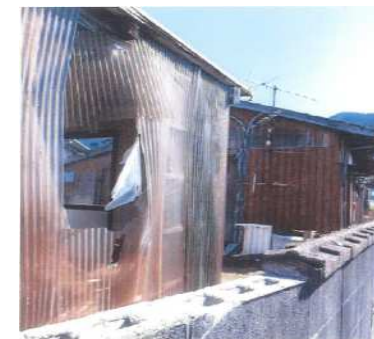
破損した民家
