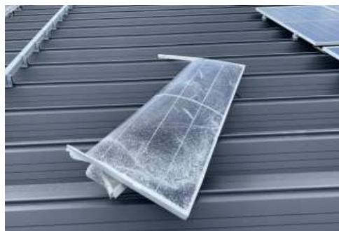
屋根上に飛散したモジュール
