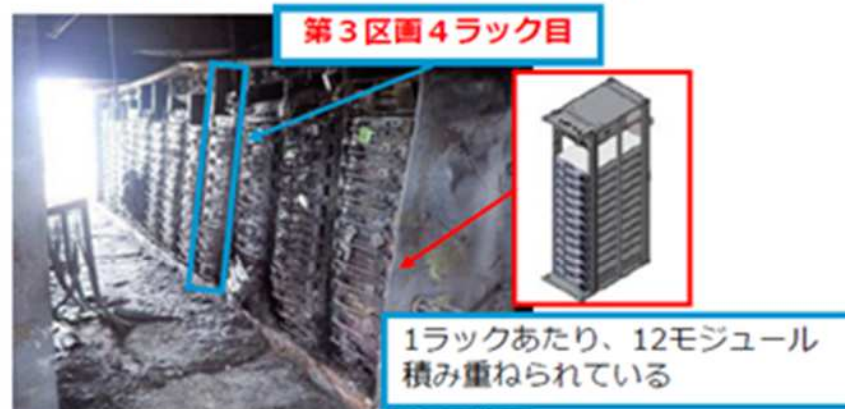
最も激しく燃えていたラックの状況
